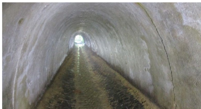
Das Bild zeigt den schadhafte Durchlass «Häftlibach».
